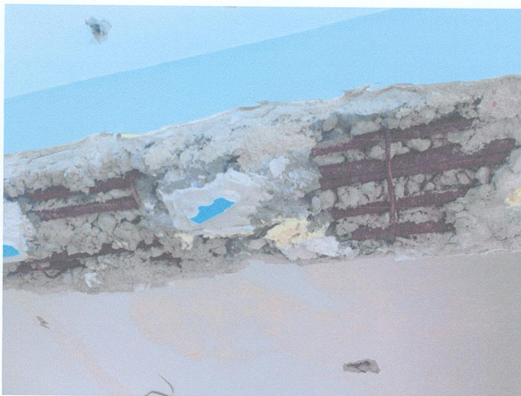
27. Структурно разрушаване на бетонното покритие на стоманобетонна главна напречна греда на трети етаж. изпълнена през 1967г. след надстрояване на трети етаж.
