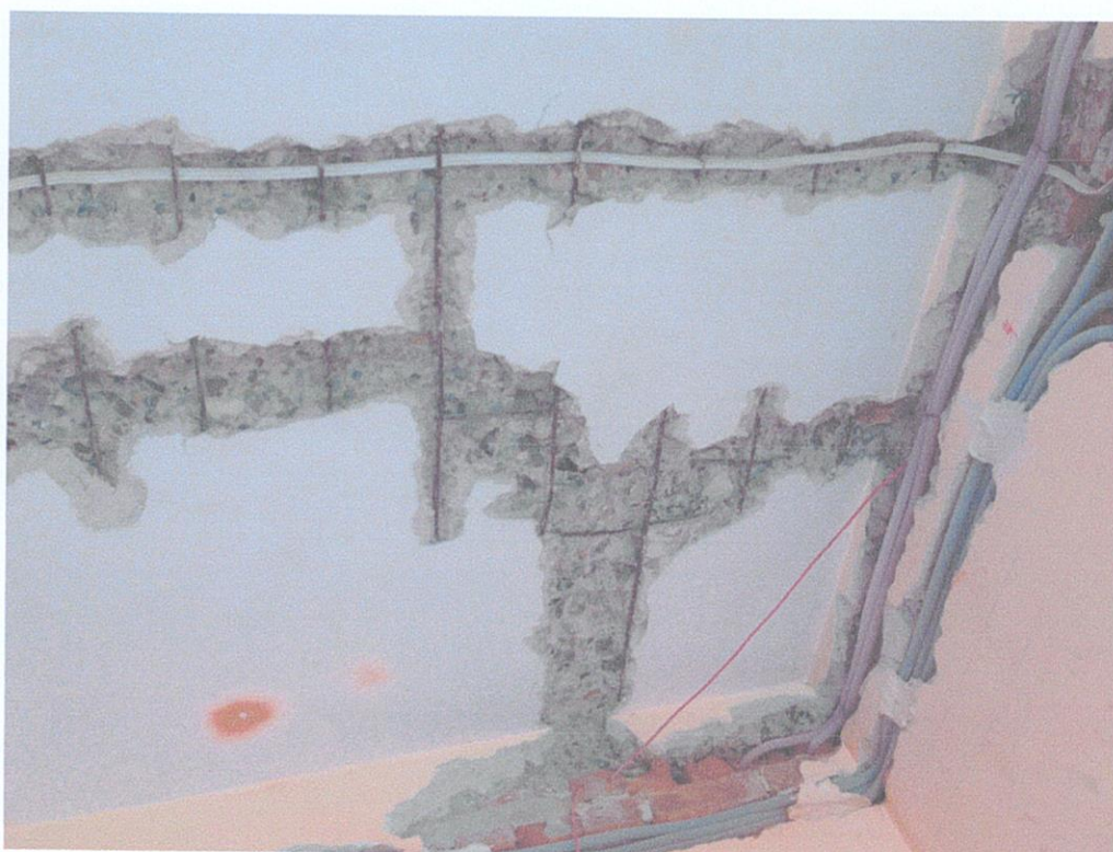
13. Прорези в ъгъл на плоча изпълнена от стоманобетон през 1962г. Прекаран е нов трижилен кабел над съществуващата армировка Освен всичко на сгрешения прорез в плочата има прерязана армировка
