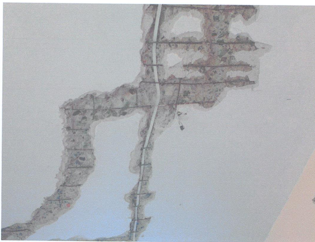
12. Прорези в средата на плоча изпълнена от стоманобетон през 1962г. Прекаран е нов трижилен кабел над съществуващата армировка Освен всичко на сгрешения прорез в плочата има прерязана армировка
