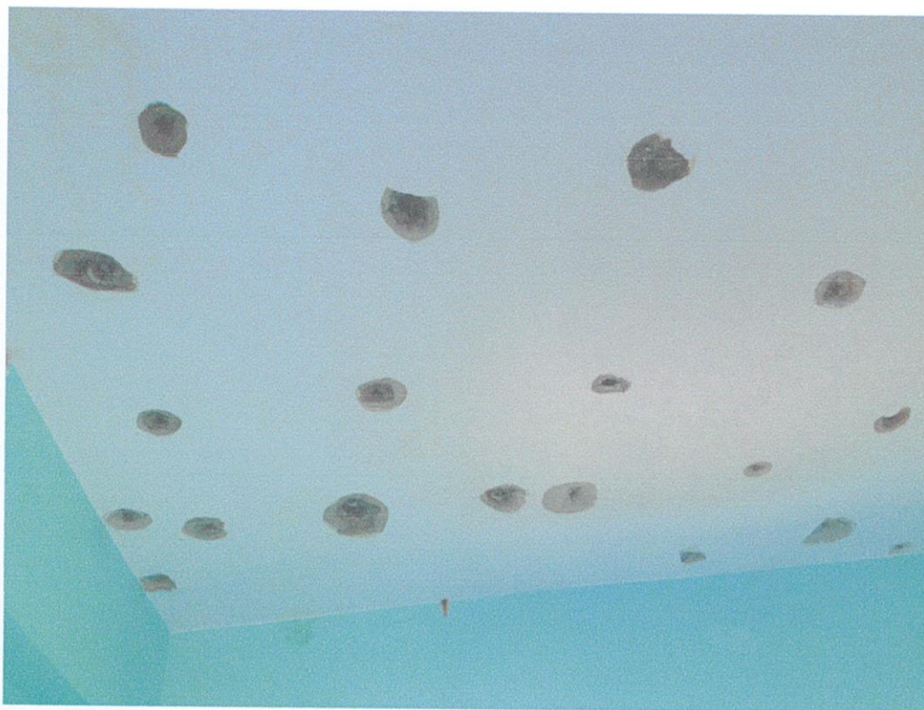
24. Структурно разрушаване на стоманобетонна тавана плоча на 3 етаж. изпълнена през 1967г. след надстрояване на трети етаж.
