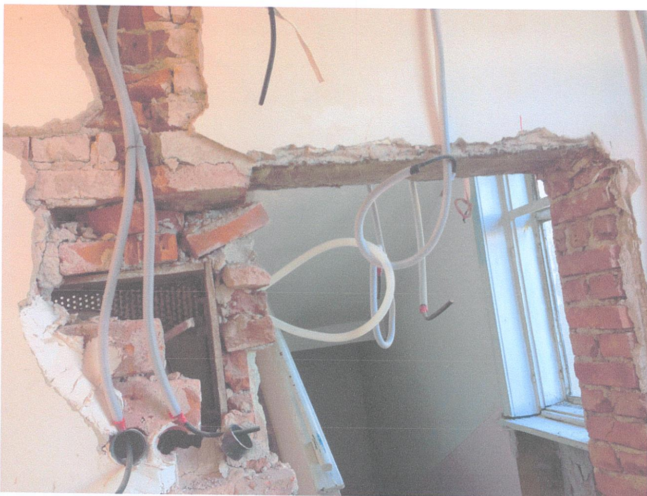
6. Неукрепен стоманобетонен щурц над отвор с монтирана ел.инсталация
