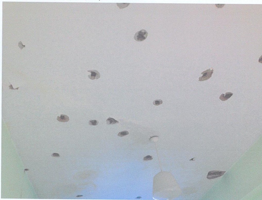
25. Структурно разрушаване на стоманобетонна тавана плоча на 3 етаж. изпълнена през 1967г. след надстрояване на трети етаж.
