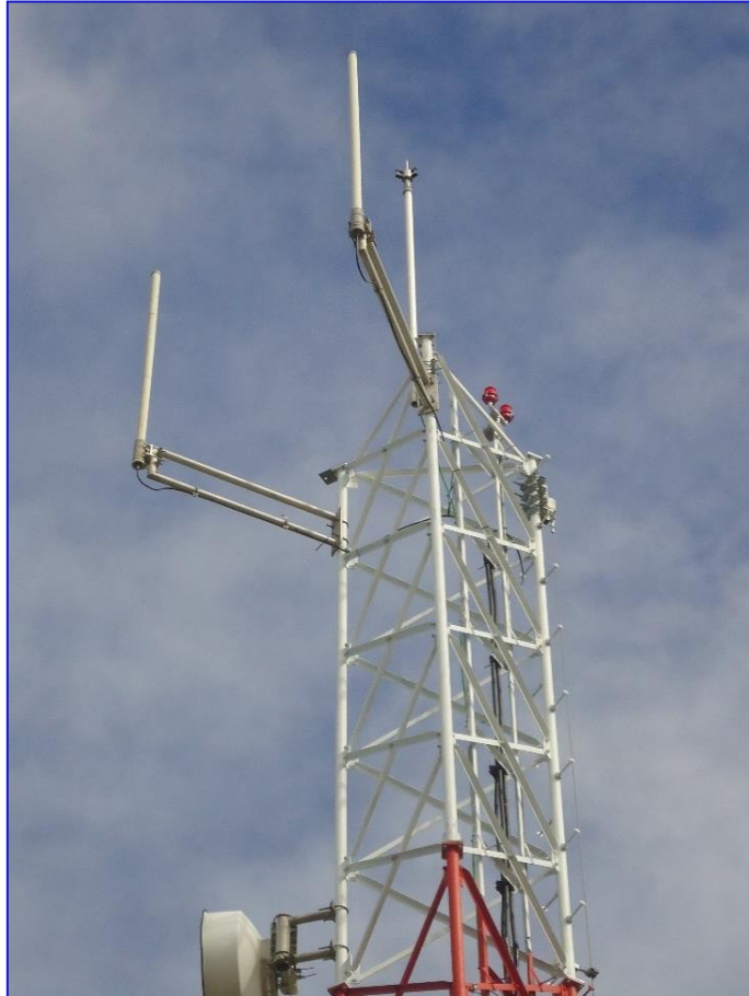
ESE in Telecom tower
