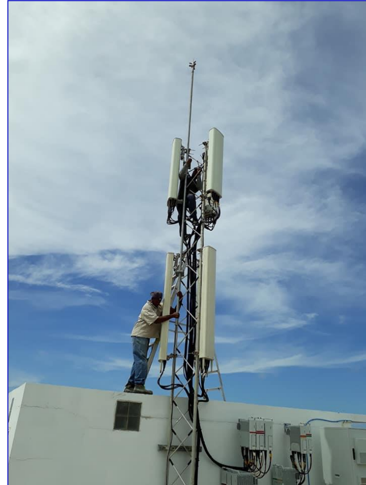
ESE in Telecom tower
