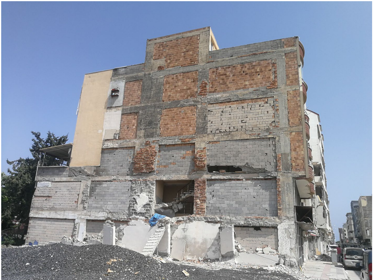
098 – сграда с рамкова конструкция с малки последствия, пострадала от допряна до нея рухнала сграда
