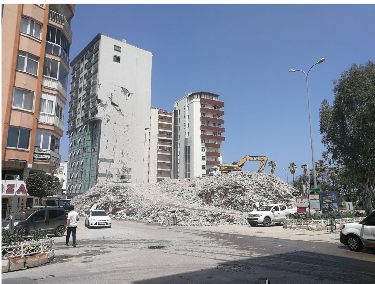
105 – зона на разчистени разрушения, дава идея за мащаба на последствията
