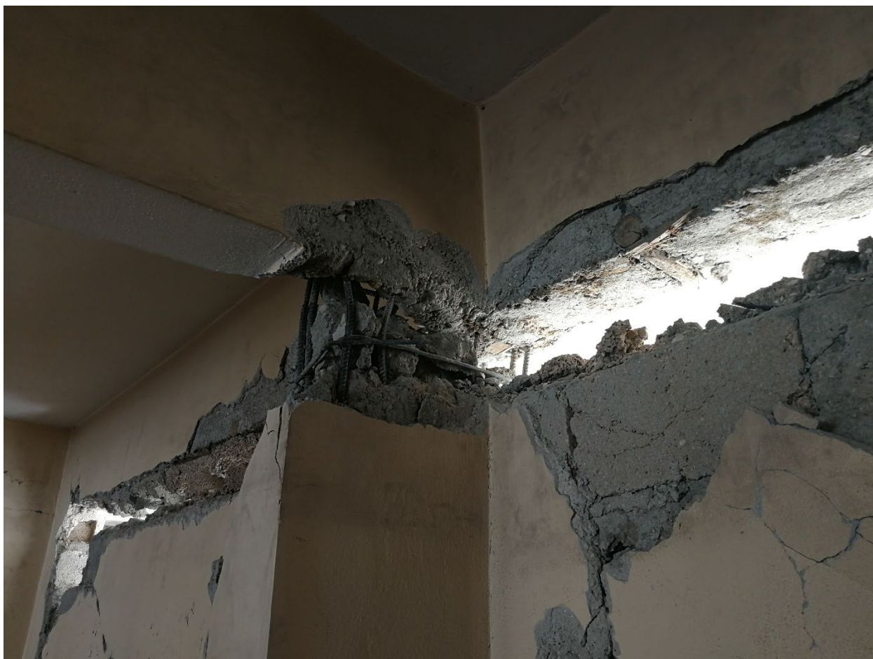
285 – същата сграда силни повреди по задната фасада
