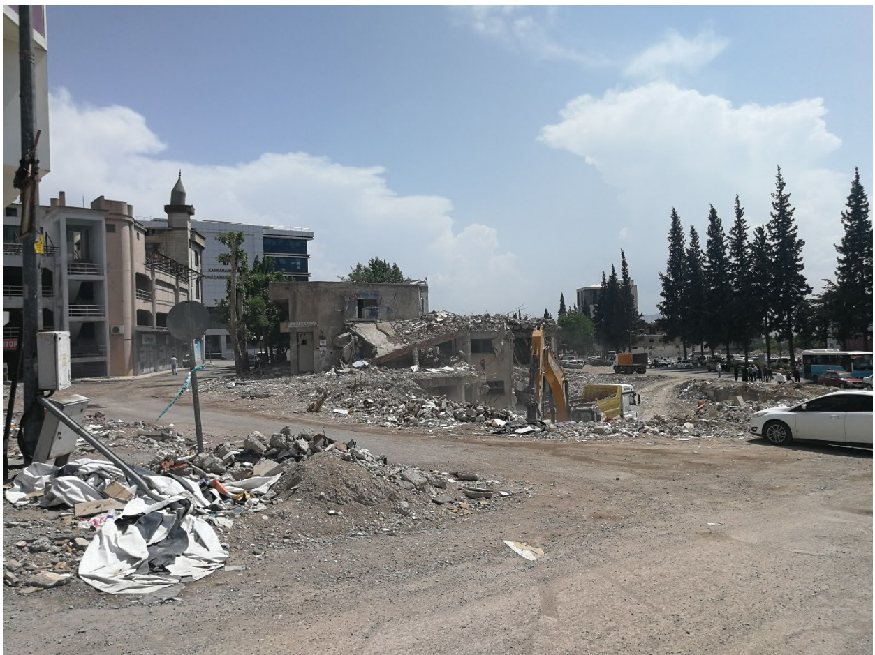
333 – зона на разчистени разрушения, дава идея за мащаба на последствията
