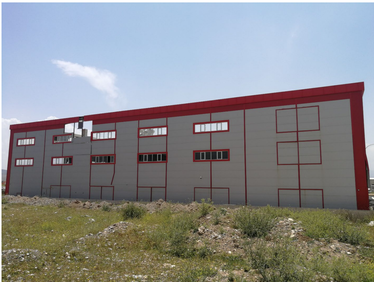
321 – сграда със сглобяема ст. б. конструкция с паднал покрив
