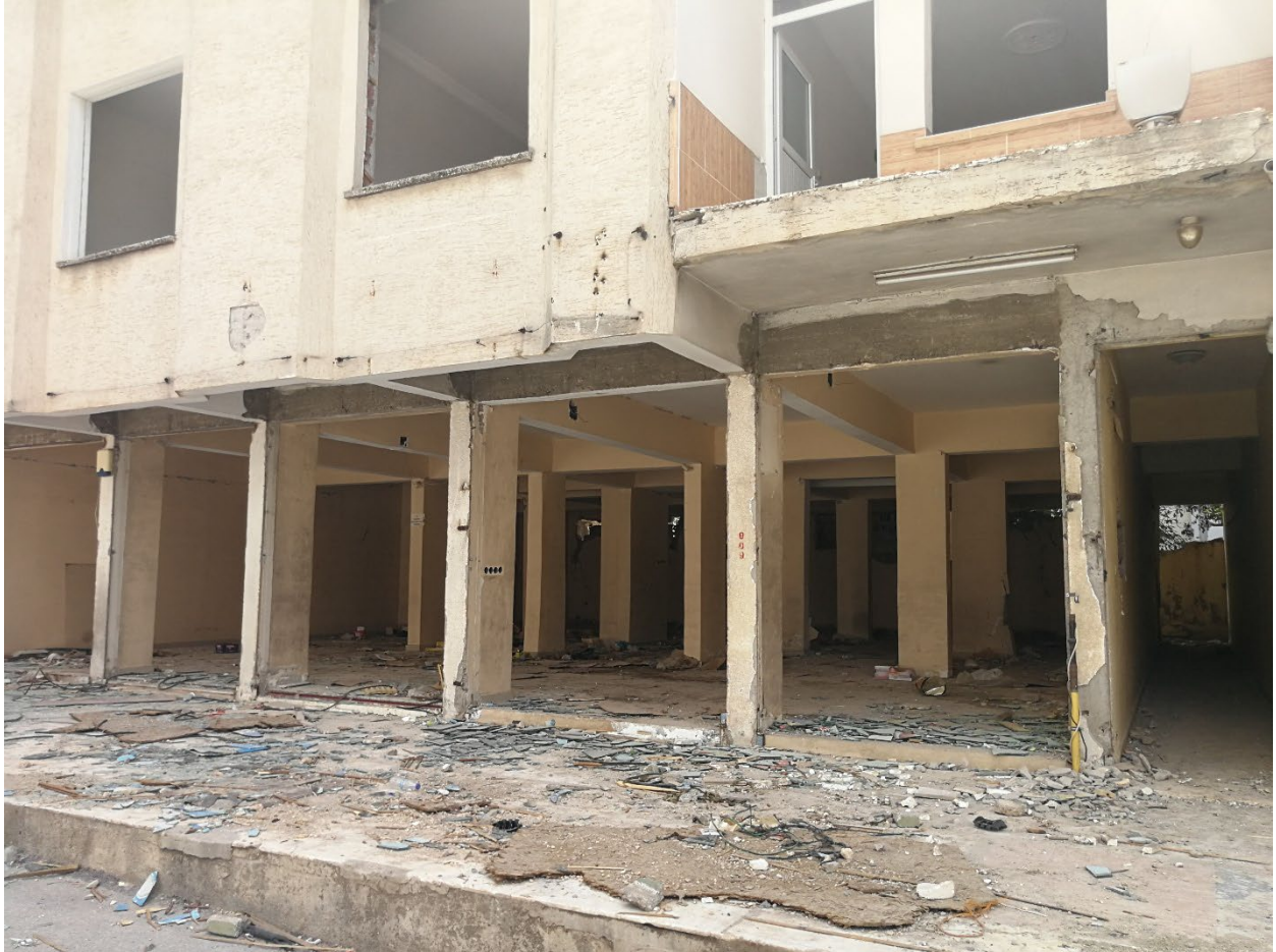
283 – сграда с мек партерен етаж с премахната явно повредена, стена по предната фасада
