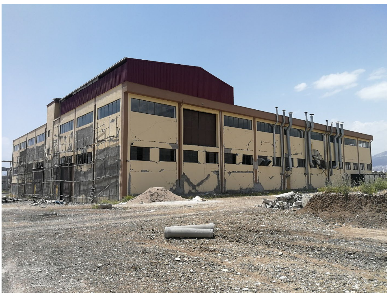
323 – сграда със сглобяема ст. б. конструкция с паднал покрив, ремонтирана със стоманен покрив
