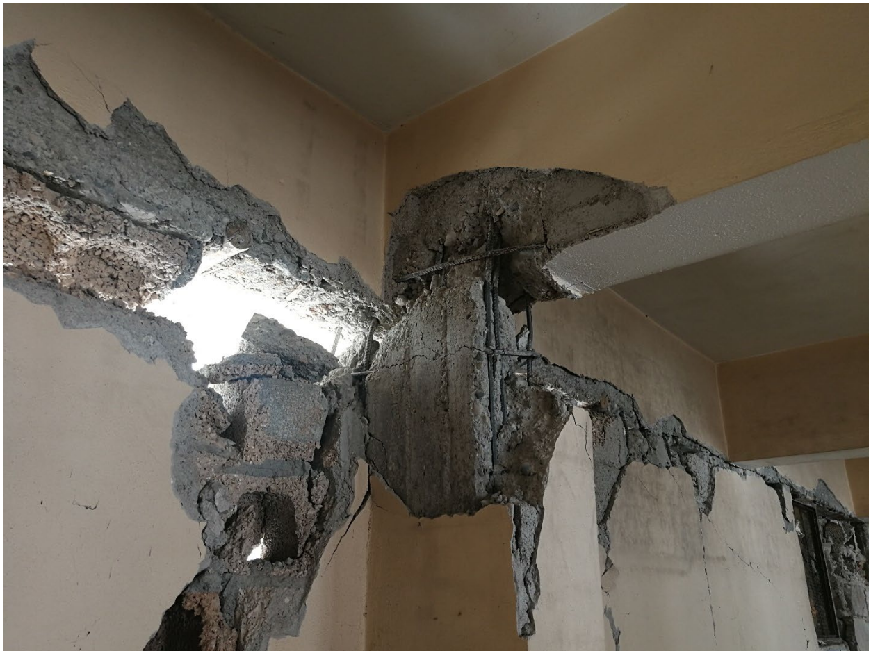
284 – същата сграда силни повреди по задната фасада
