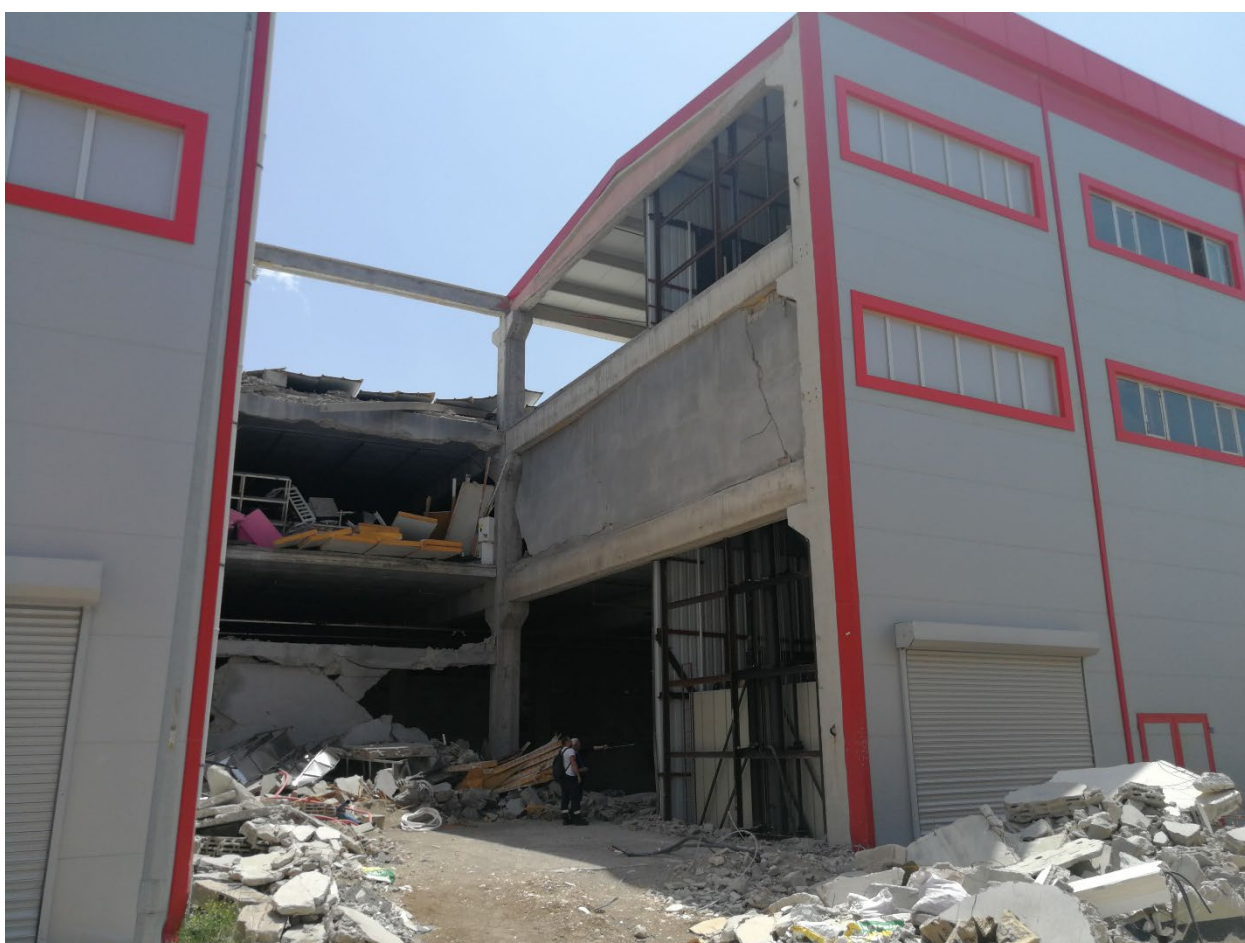
319 – паднали покриви ст. б. столици и съответно леки покривни панели
