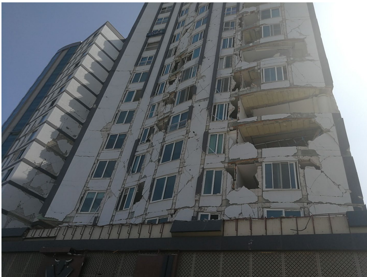
071 – типична нова висока жилищна сграда с пострадала фасада
