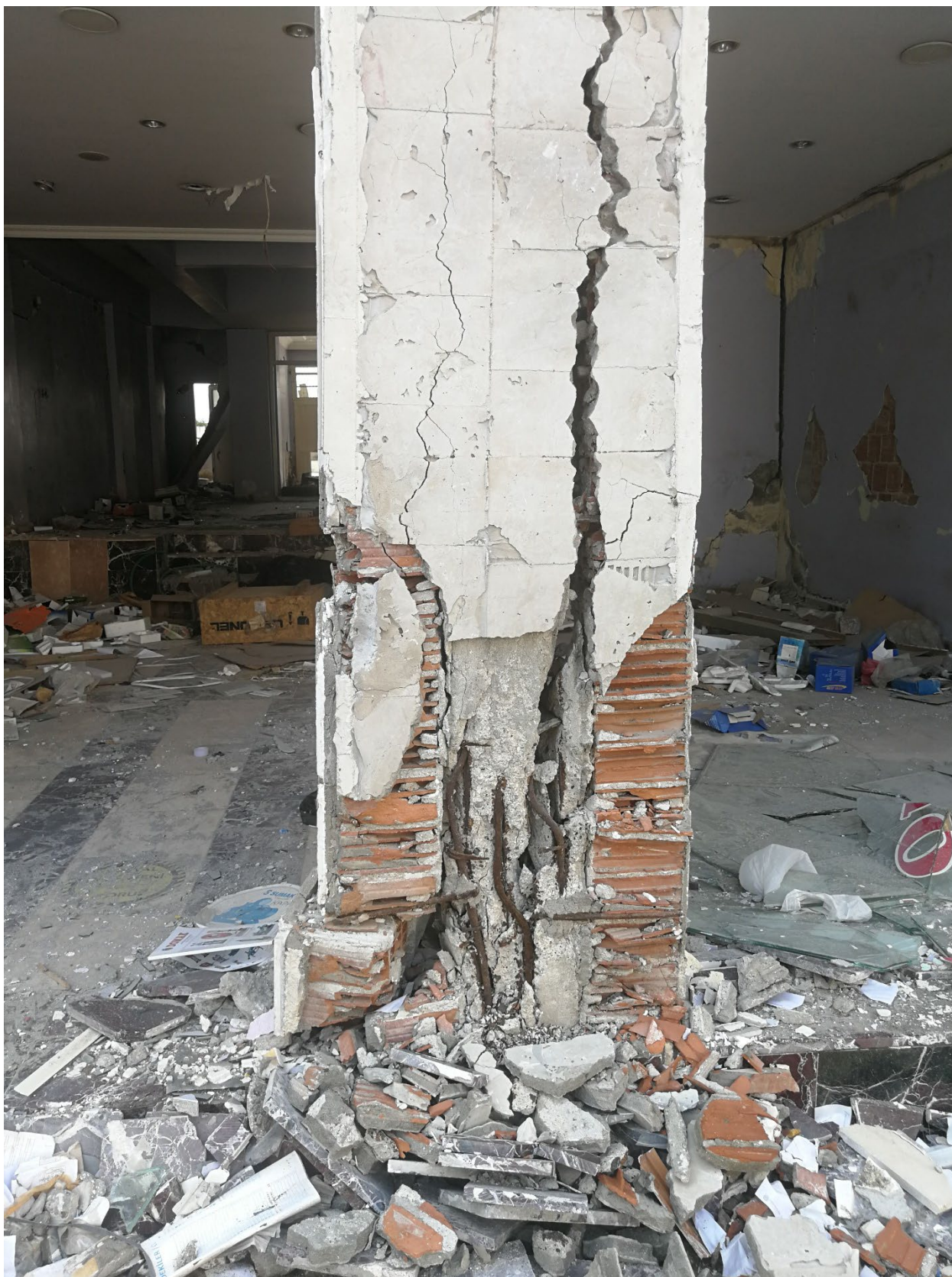
085 – същата сграда, детайл на претоварена от огъване по фасадата колона
