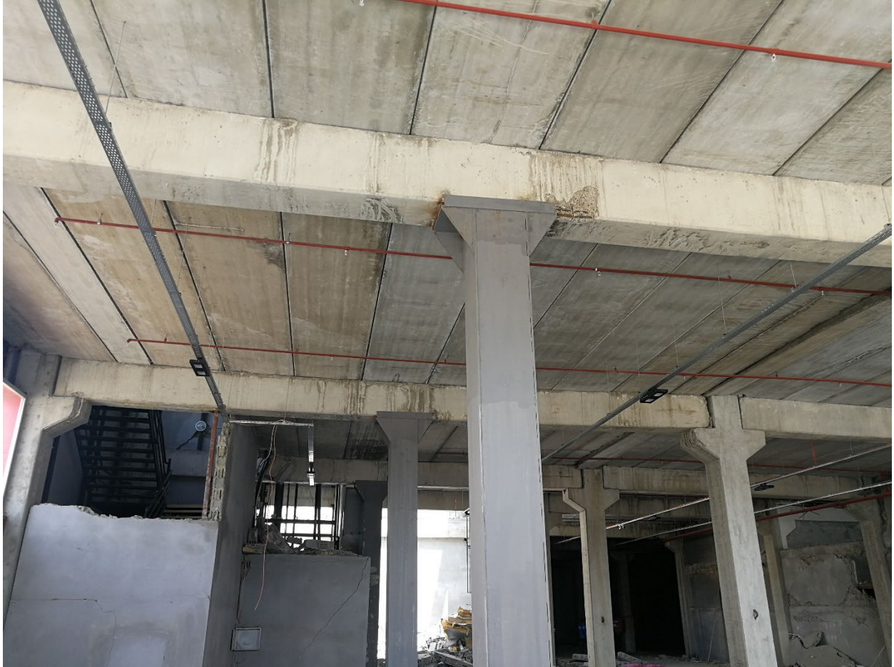
313 – подпиране със стоманени колони на провиснали сглобяеми ст. б. греди
