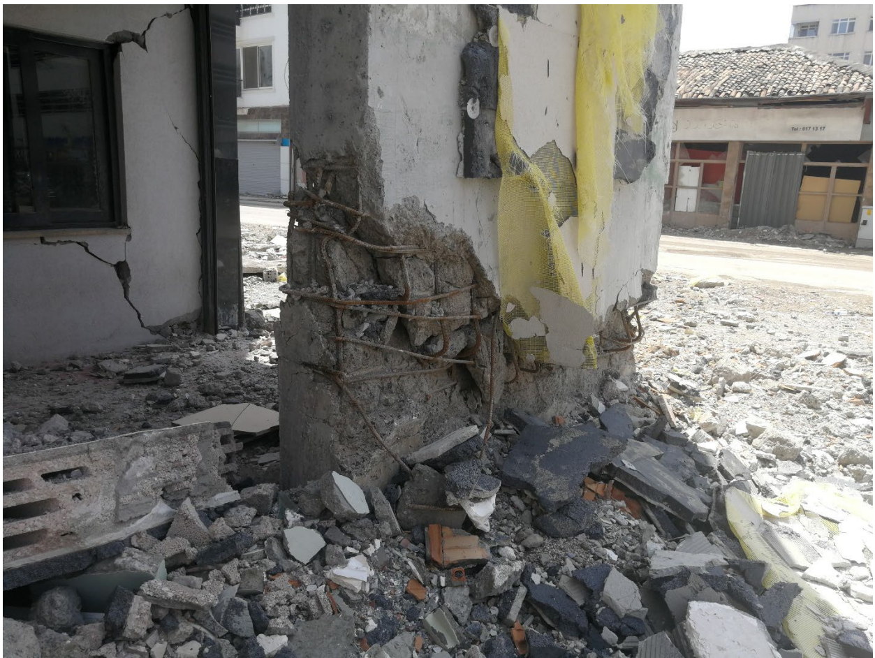
155 – изкълчване на носещи жезеза в шайби
