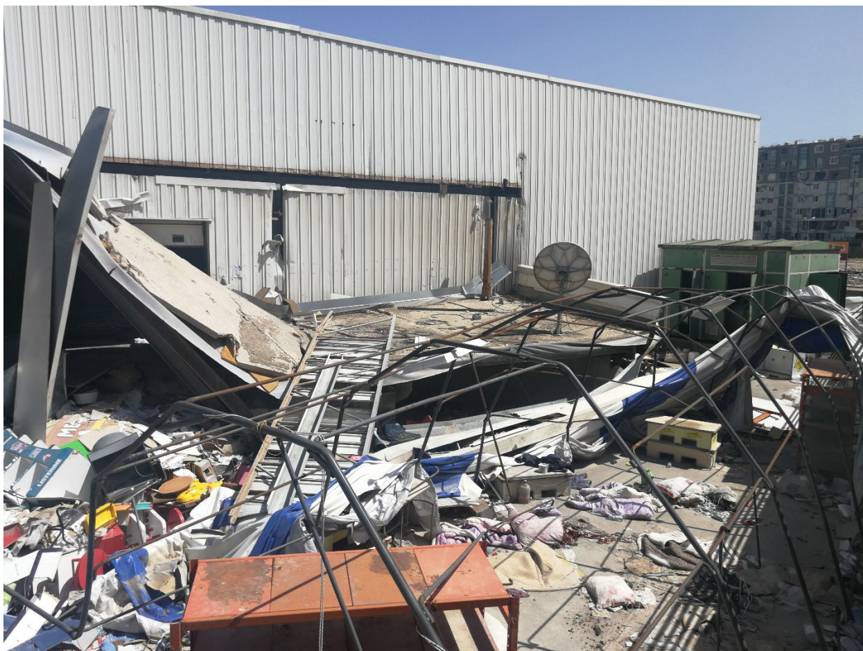
210 – съборена козирка на същата индустриална сграда
