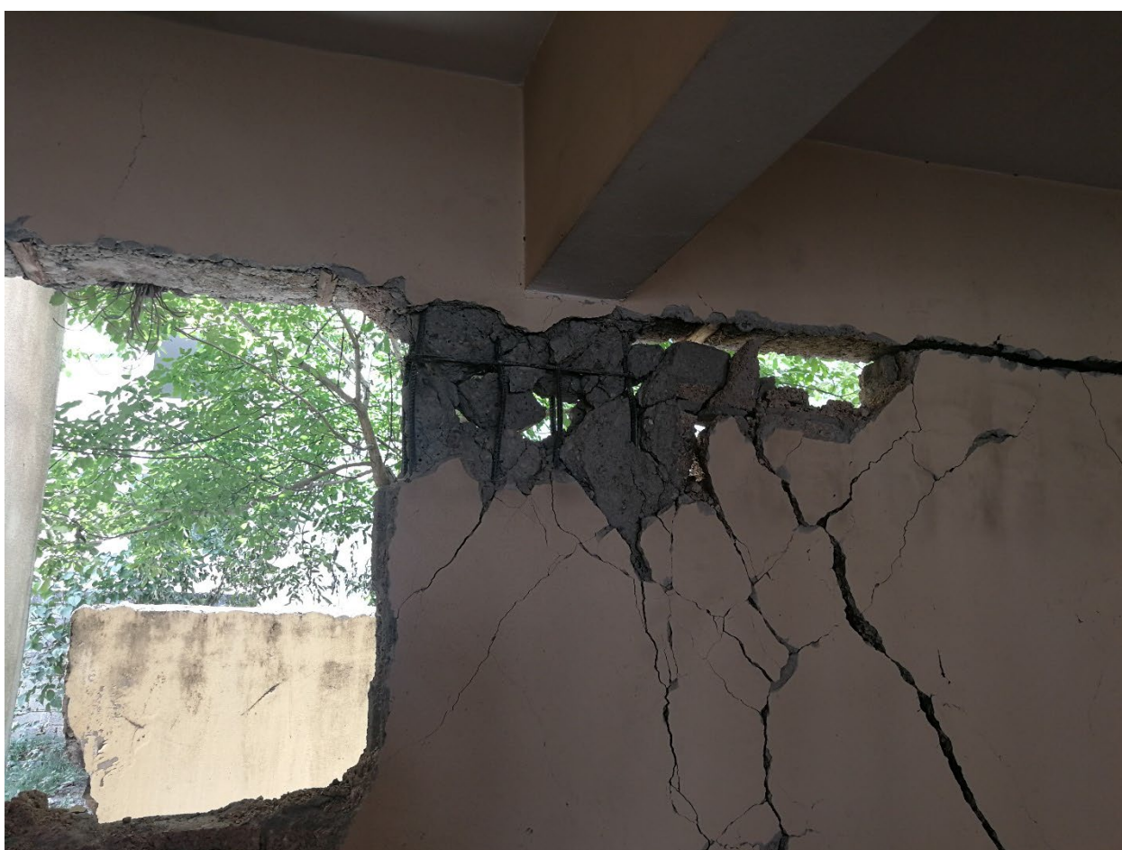
287 - същата сграда силни повреди по задната фасада
