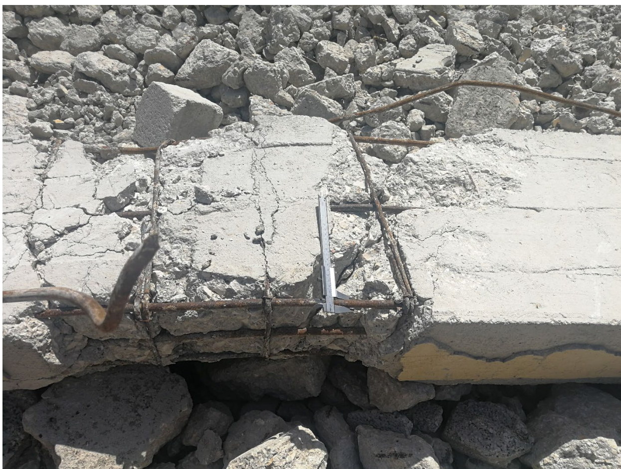
197 – парче от ст. б. колона, армирана по стари норми, останала от напълно разрушена от земетресението сграда
