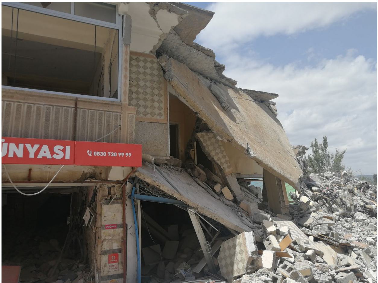
292 – разрушена неадекватно армирана плоча
